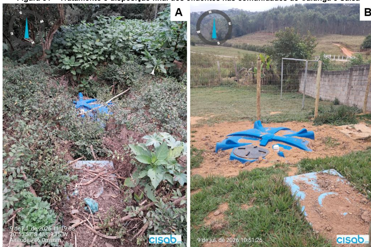
Figura 81 – Tratamento e disposição final dos efluentes nas comunidades de Calunga e Salsa
