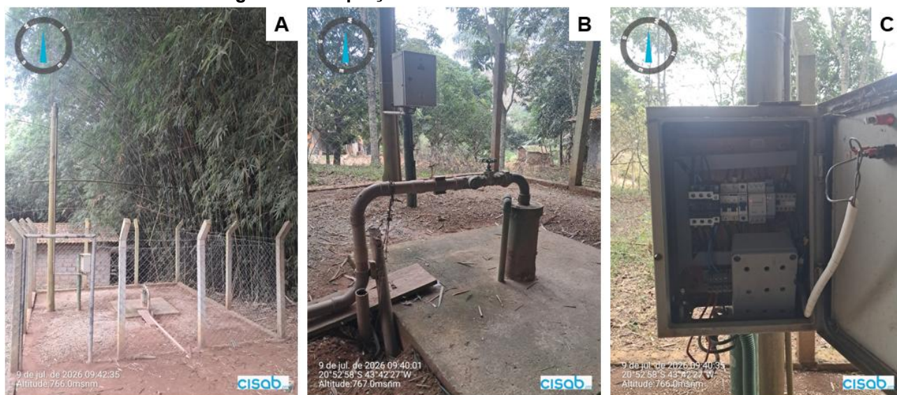
Figura 43 – Captação Subterrânea Bernardo Corrêa II
