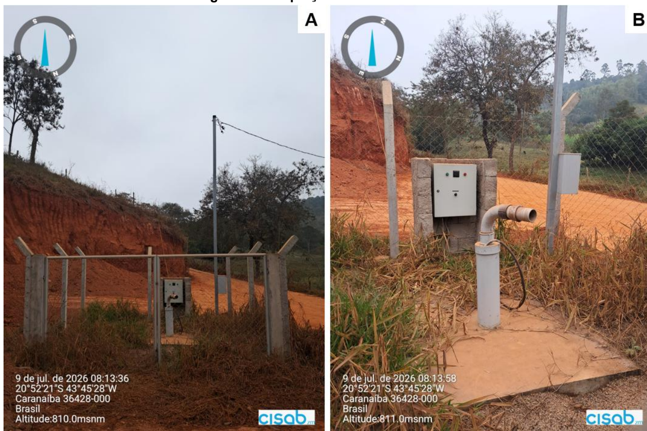
Figura 31 – Captação Subterrânea Olaria
