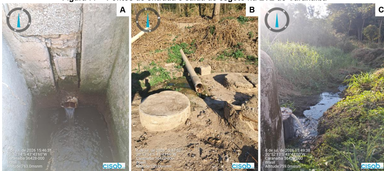
Figura 77 – Pontos de entrada e saída de esgoto na ETE de Caranaíba
