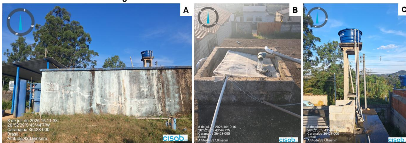
Figura 37 – Reservatórios da ETA Caranaíba
