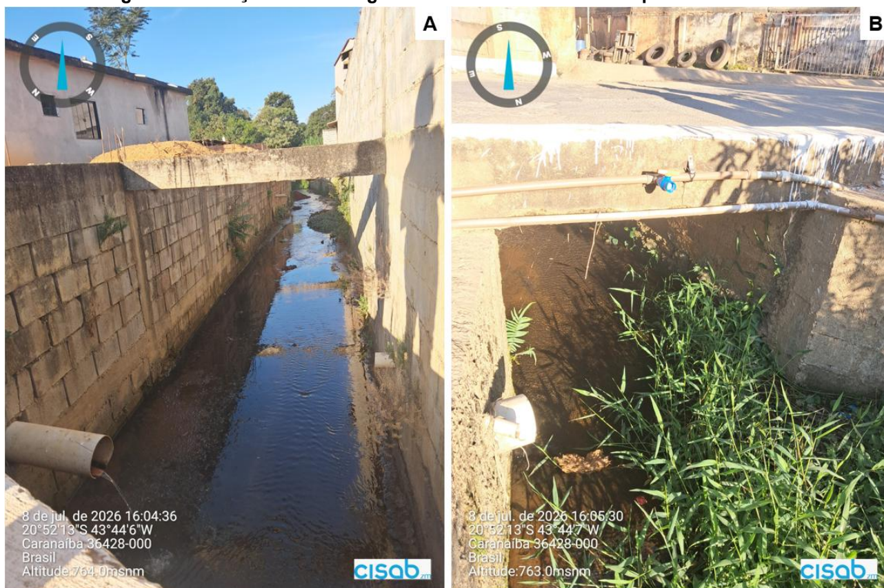
Figura 79 – Lançamento de esgoto na área da sede do município de Caranaíba
