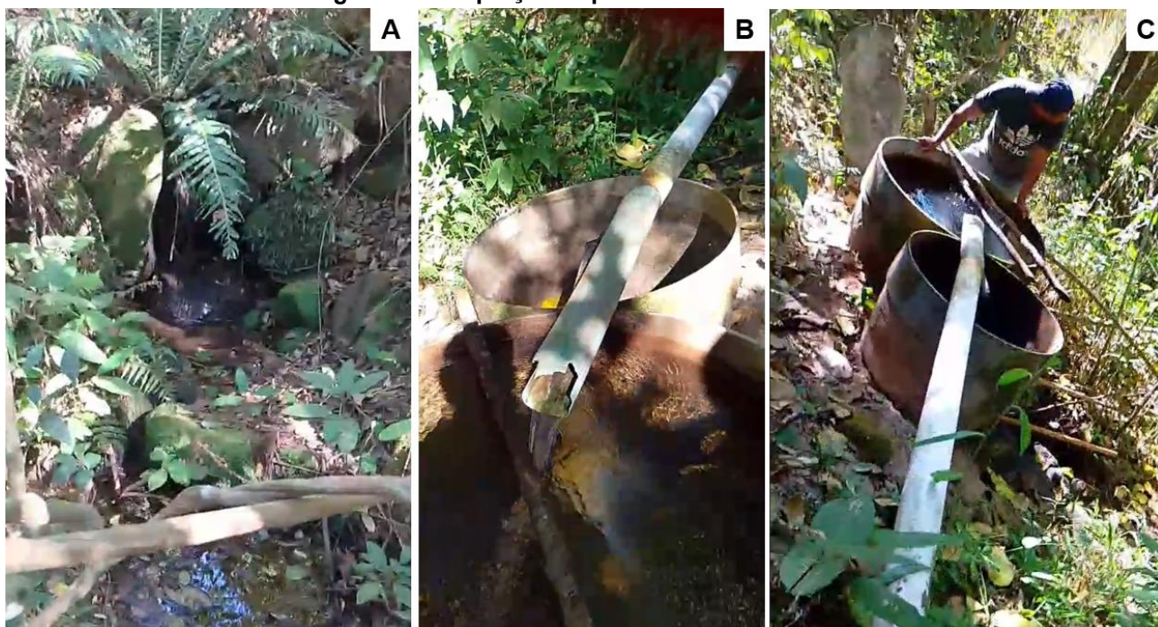
Figura 54 – Captação Superficial – Fazenda Baú
