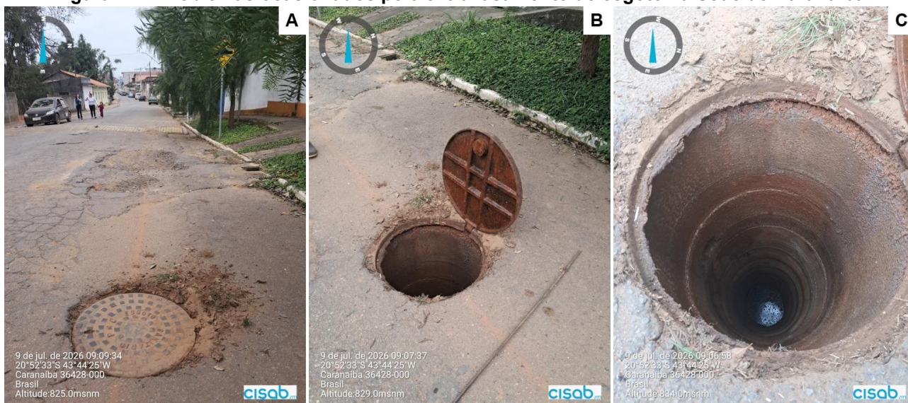
Figura 74 – Problemas ocasionados pelo extravasamento de esgoto na Sede de Caranaíba
