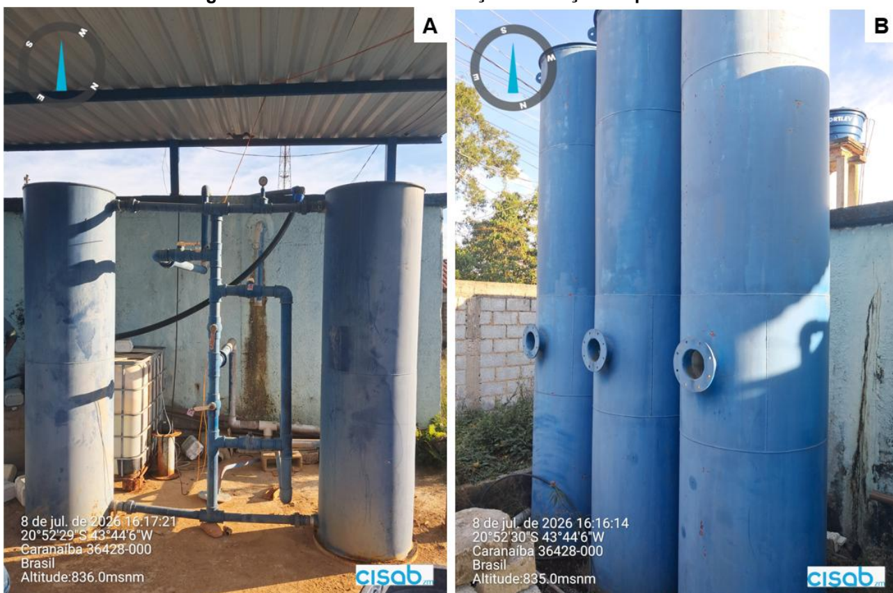
Figura 36 – Sistemas de decantação e filtração inoperantes
