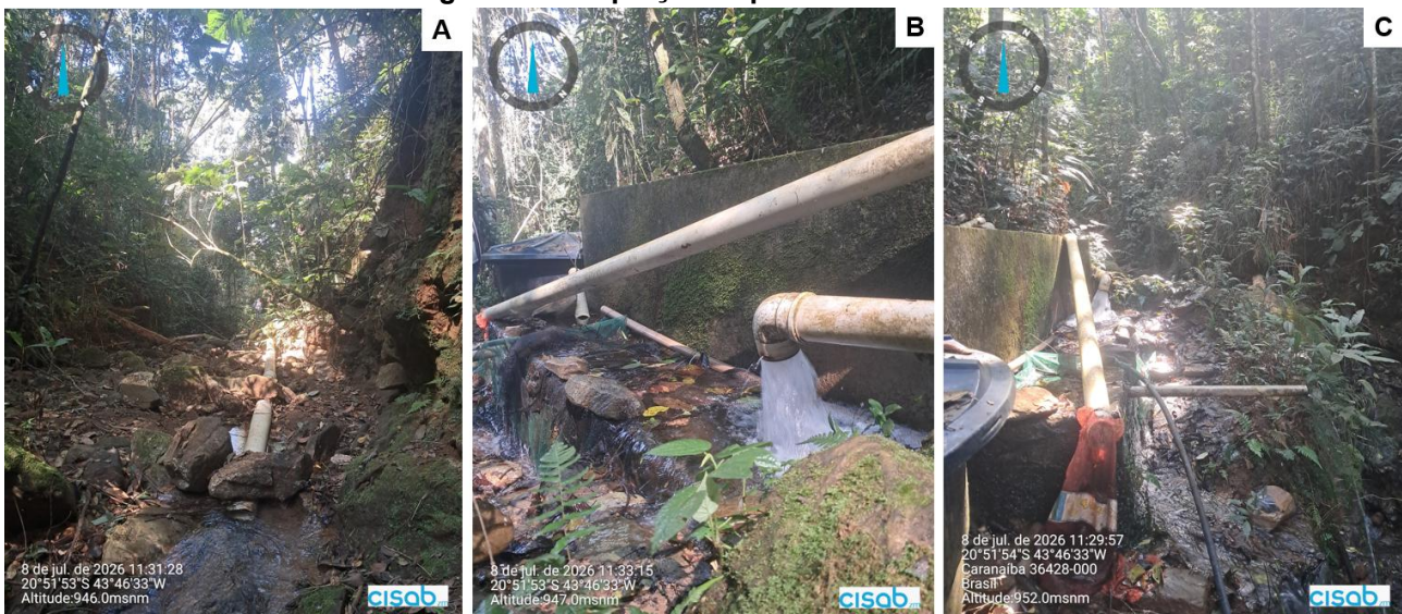
Figura 70 – Captação Superficial Inhame II
