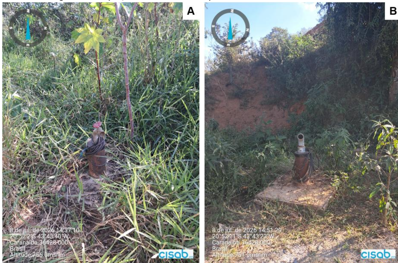
Figura 62 – Captações subterrâneas inoperantes na Comunidade Fernandes
